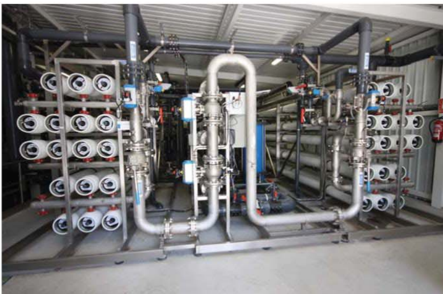
Figura 10. Bastidores de membrana de ósmosis inversa
