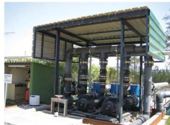
Figura 4. Bombeo de agua bruta
