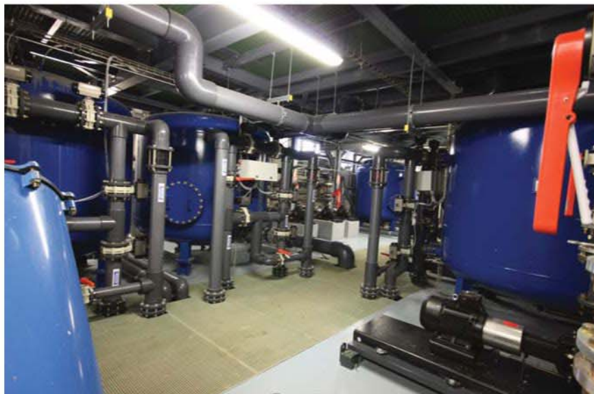
Figura 5. Filtros de arena
