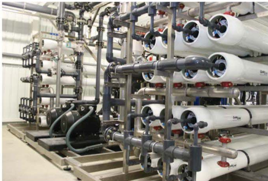
Figura 11. Bastidores de OI y bombas de alta presión
