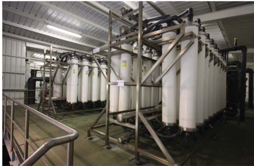
Figura 6. Bastidores de ultrafiltración
